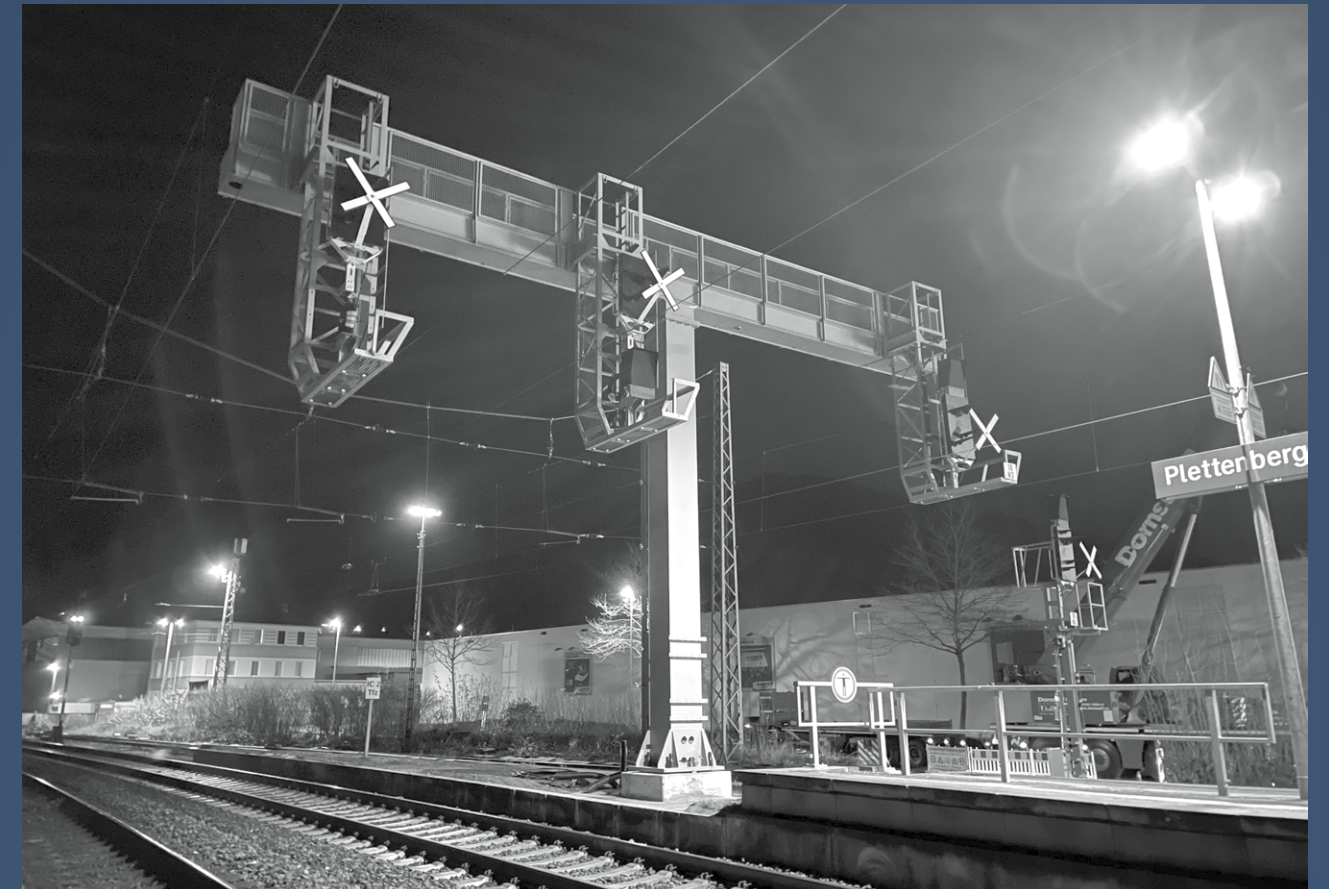
T-Ausleger im Einfahrbereich Bahnhof Plettenberg
